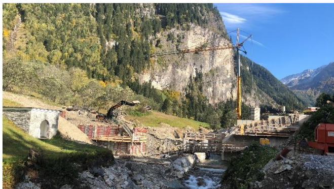
Dosiersperre Nähe Plattenbach
